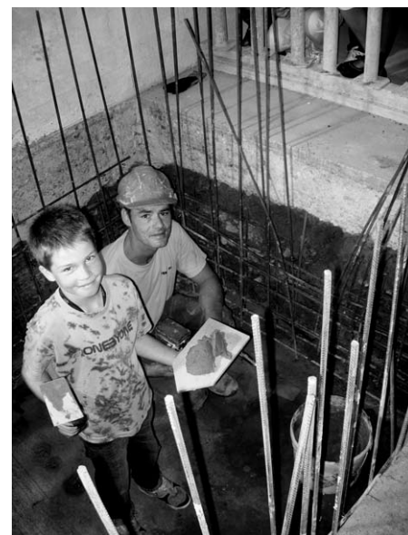
Simon mauert die Büchse in das Fundament des Liftschachtes ein. (Fotos: F. Suter)
